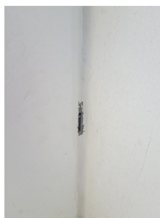
Abb. 12: (6) 1.OG, Mehrzweck-Nutzung, 95,5 qm, Fugenmasse
