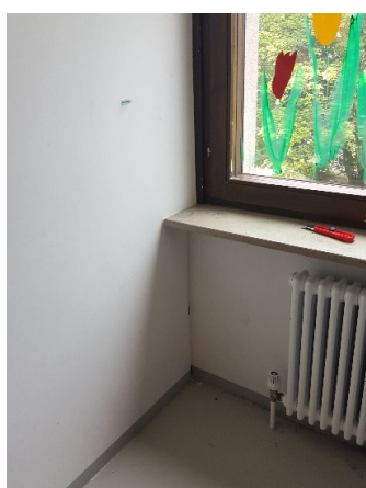
Abb. 11: (6) 1.OG, Mehrzweck-Nutzung, 95,5 qm, Fugenmasse
