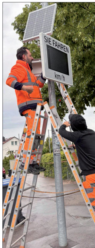
Die Installation eines neuen Geräts dauert rund 30 Minuten. Foto: cop
