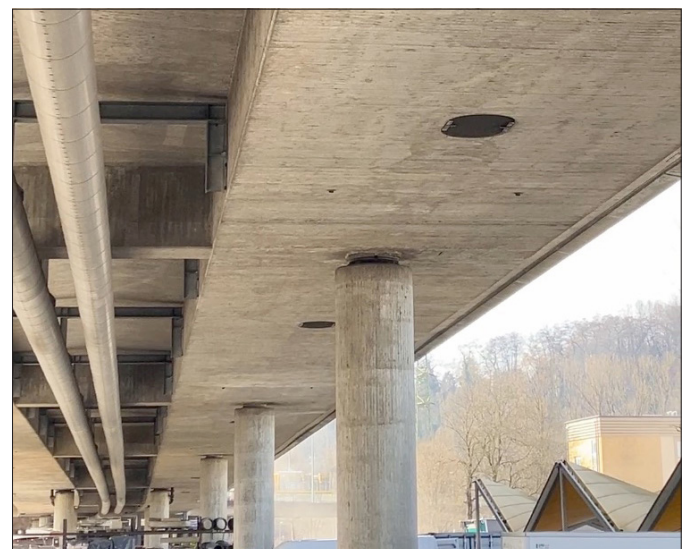
Bei den neuesten Untersuchungen wurden im Inneren der Brücke beschädigte Spannglieder entdeckt – tragende Stahlseile sind teilweise korrodiert und angerissen. Foto: mam
