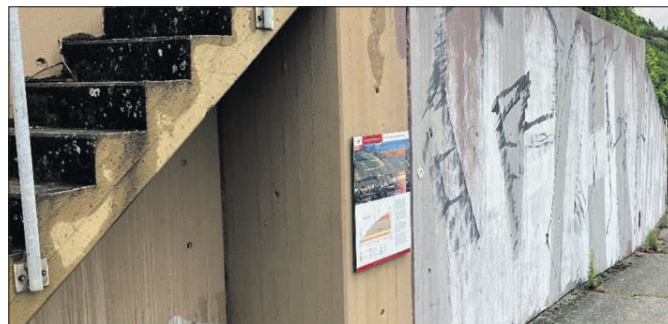
Vorher-Nachher-Vergleich: So sah die Betonwand vor der Kunstaktion aus.
