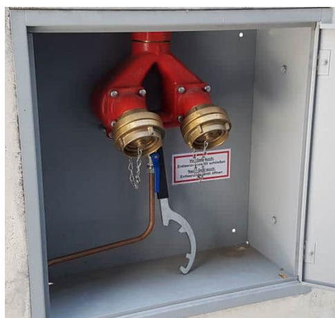
Abbildung 6 Beispiel für Löschwasser-Einspeiseeinrichtung © Feuerwehr Esslingen a. N.
