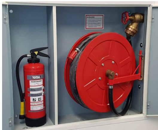
Abbildung 1 Wandhydrant Typ F © Feuerwehr Esslingen a. N.
