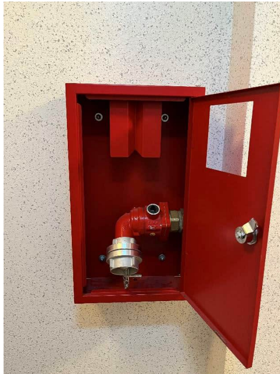
Abbildung 7 Beispiel für Löschwasser-Entnahmeeinrichtung © Feuerwehr Esslingen a. N.
